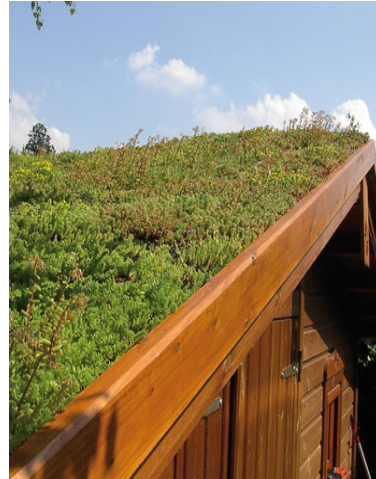
toiture en pente végétalisée
