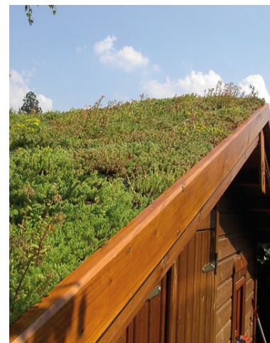
toiture en pente végétalisée
